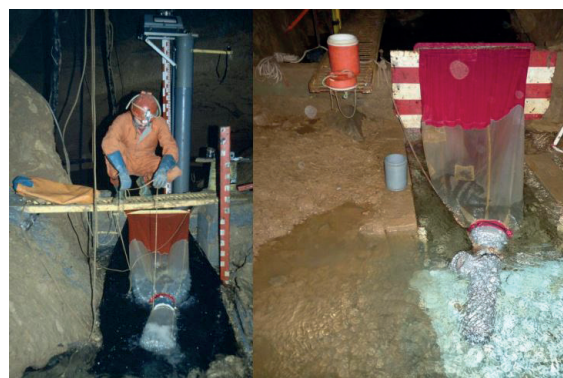
Figure 4: Photos in situ du dispositif de filtrage permanent au niveau du déversoir LM1 (à gauche), et du déversoir LM0 (à droite), d'après Bou et al., 2015..
